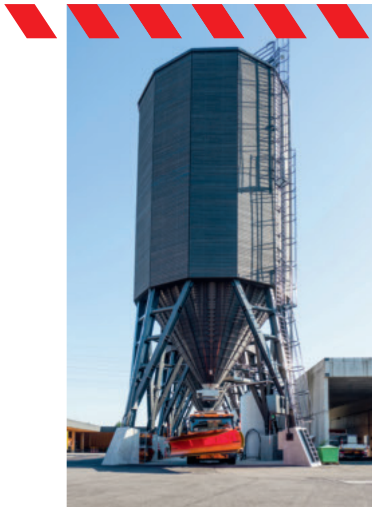
Gegen Schnee und Eis: Salzsilos im Autobahnwerkhof Bern über einem Räumfahrzeug.
